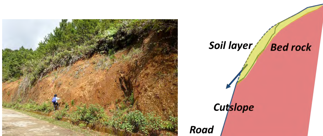
図 4-2-2-13c 調査対象区間で多く見られた崩壊形態
