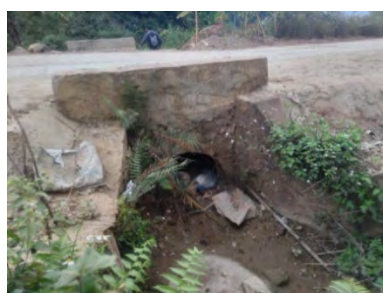
図 4-2-2-27 土砂堆積による暗渠の閉塞
