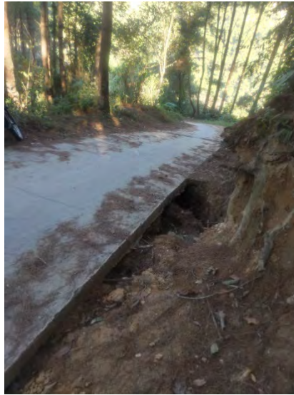
図 4-2-2-32 コンクリート舗装下部にできた空洞
