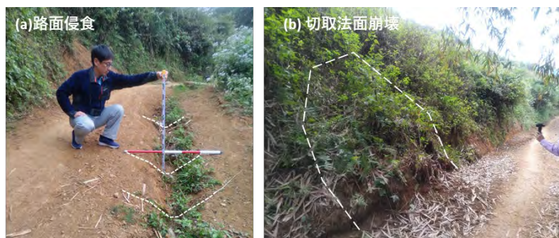
図 4-2-2-30 Rural Road で見られた路面侵食、小規模な切取法面崩壊
