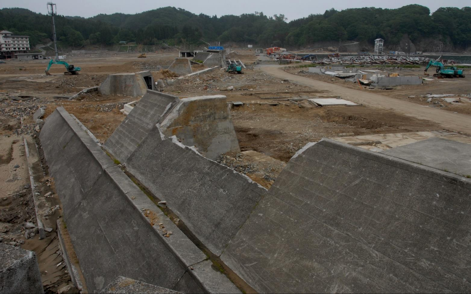
高さ10m以上の防潮堤も津波で破壊された（田老町） Seawall (>10m high) destroyed by tsunami (Iwate, Japan)
